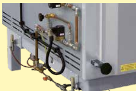
Plynová trasa a termočlánek na komorové pece
